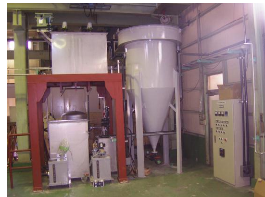
排水処理設備
